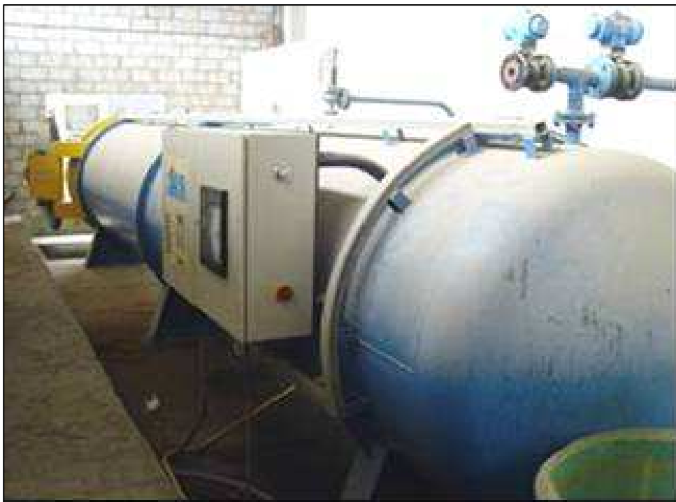
Autoclave que se emplea en el tratado de maderas propiedad de Valledor S.Coop.
